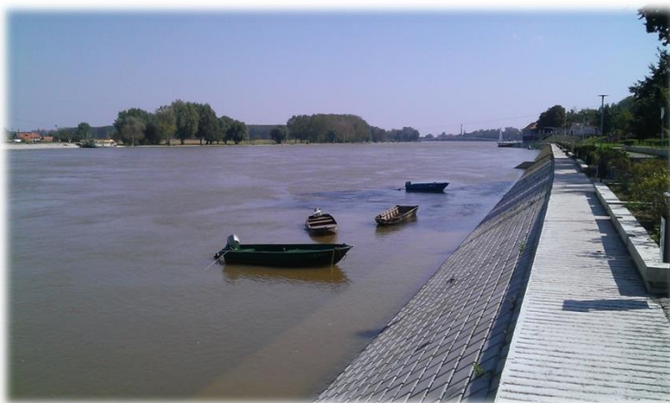
Slika 4. Fotografija obaloutvrde na rkm 22 – izvor: arhiva Hrvatskih voda Figure 4. Photo of coastal fortification on river km 22 – source: Hrvatske vode archive
